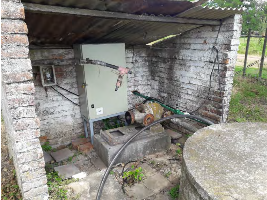
Caseta contigua a la perforación con sistema de cloración
