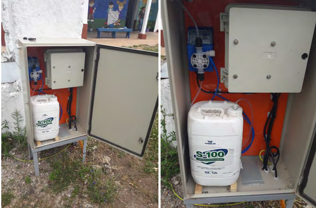
Sistema de cloración
