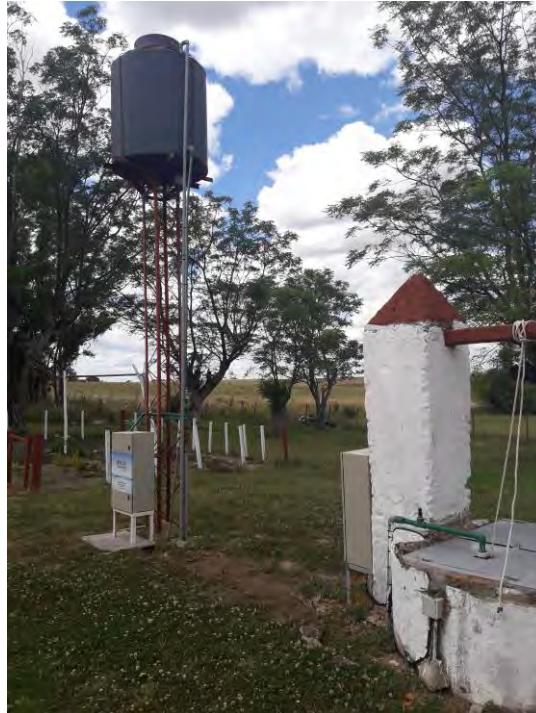
Vista general del sistema de cloración y filtro de carbón activado
