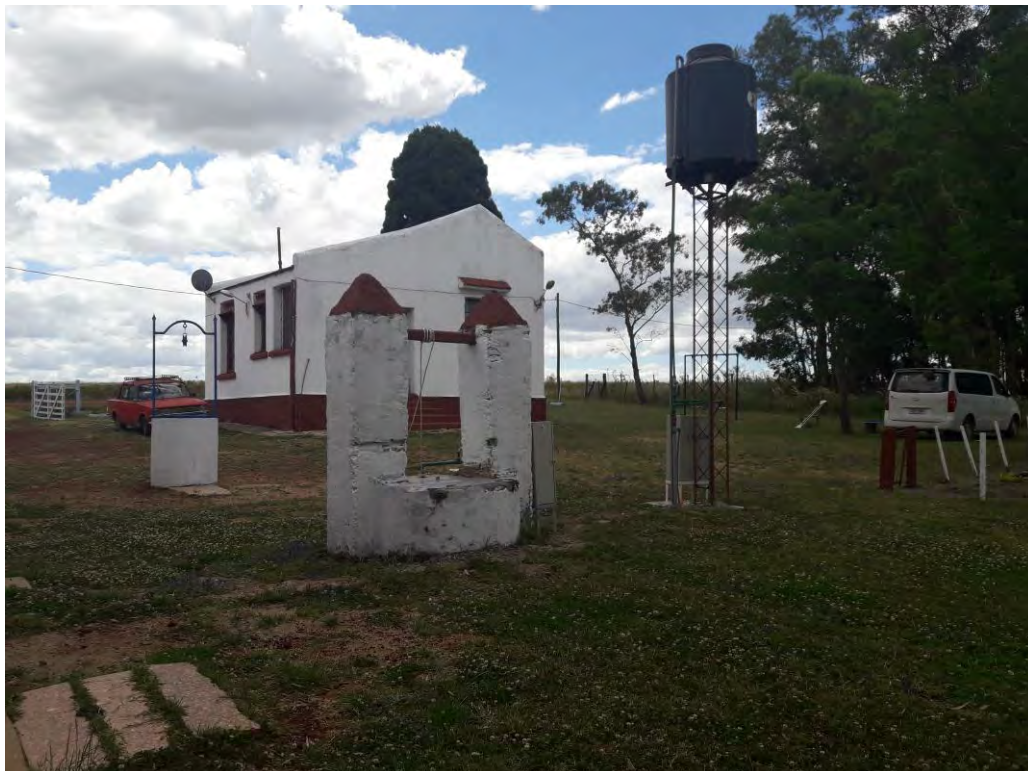
Perforación existente con los sistemas de cloración y filtro de carbón activado
